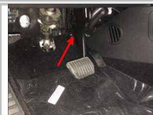
3.4、驾驶室线束穿线位置；
