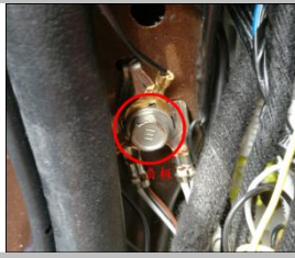
2.11 负极 ：负极在保险盒附近位置看到不带油漆的螺栓柱，装上连接片拧紧；
