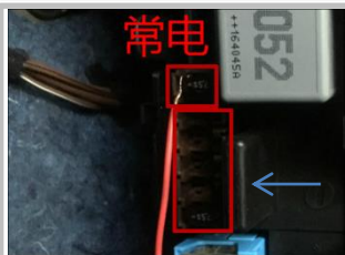
2.17 安装方式二接正极常电： 将我司取电器上保护帽剪掉，露出铜丝缠在正极对应保险盒内，图示已安装好；(箭头)
