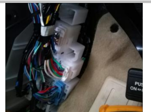
2.9 正极：在驾驶室 A 柱底下看到此原车线束盒，在底下此线束连接器找到较粗的一根黑色线；
